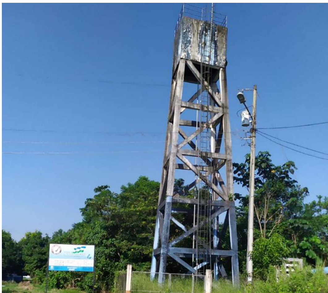
Fotografía N° 2. Sistema de agua. Comunidad Aucayacu.
