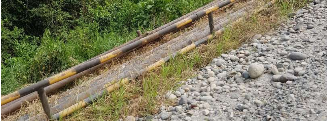
Fotografía N° 5. Sistema de oleoducto.
